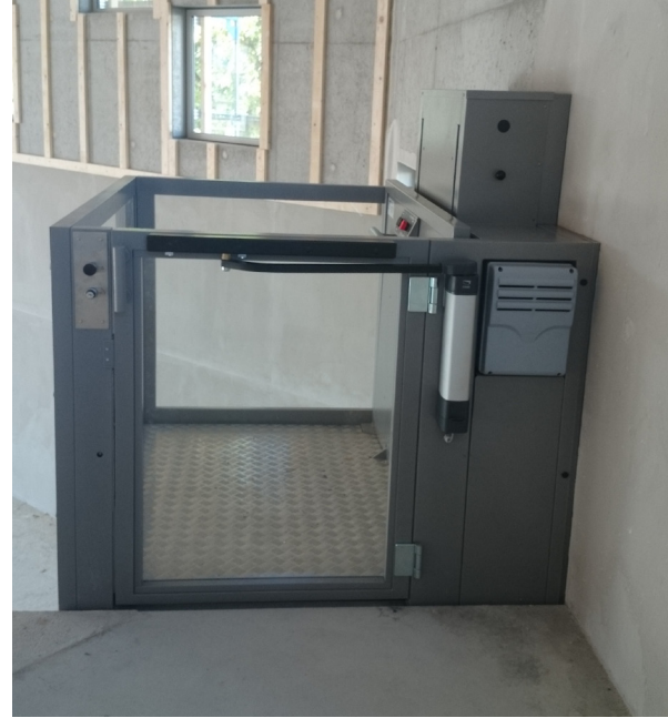
Obere Tür mit automatischem Türöffner
